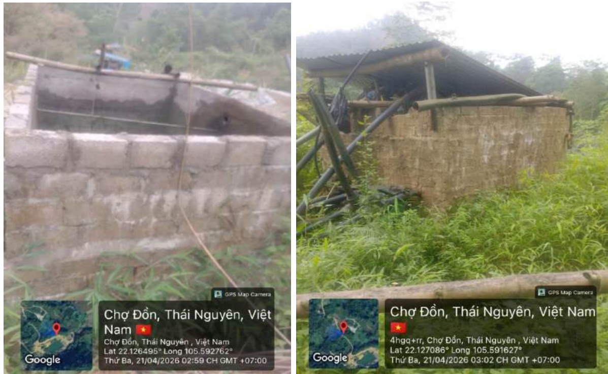
Hình 3.7. Bể chứa trung gian số 1 và bể chứa trung gian số 2
